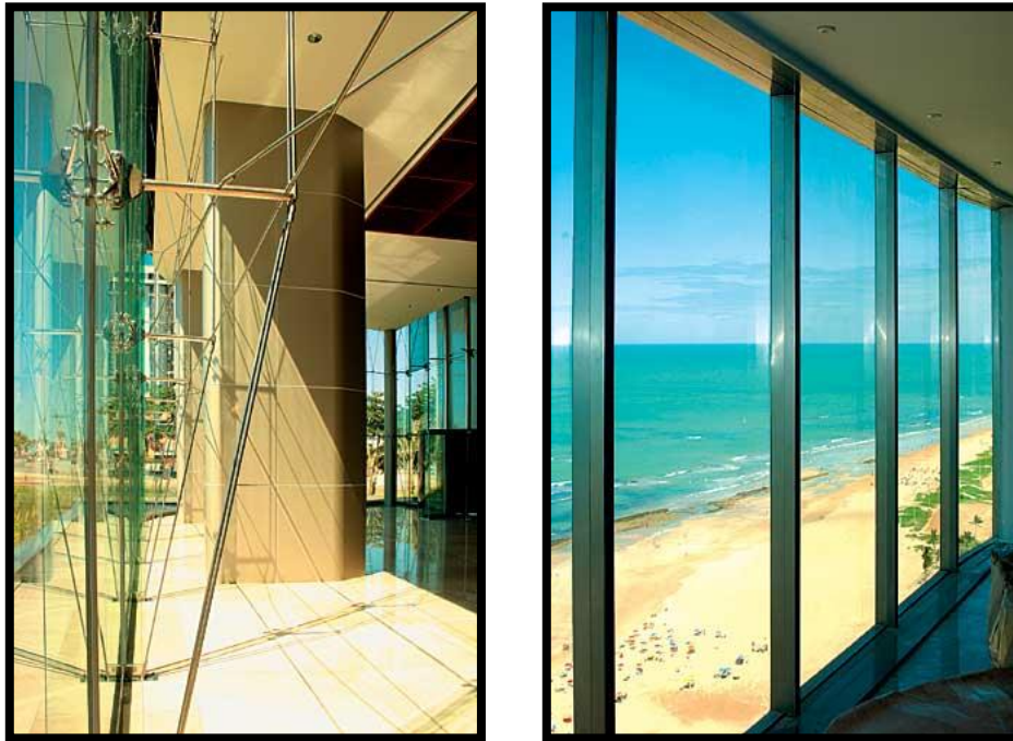
FIGURA 33 e 34: Estrutura de fixação da esquadria, no térreo e no pavimento tipo.
