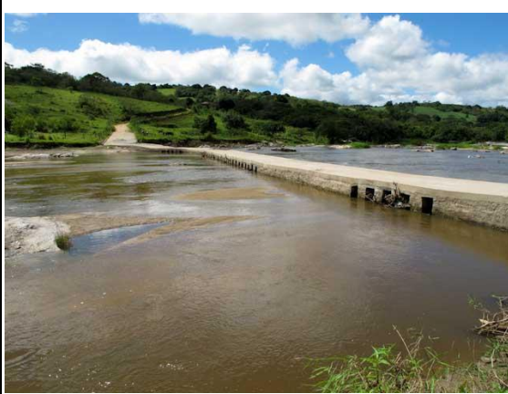
Figura 13: Grande “passagem molhada” entre São Joaquim do Monte e Agrestina, PE, na verdade uma estrutura intermediária entre uma passagem molhada e uma ponte, mas que exerce efeito análogo a uma barragem (foto: do próprio autor).
