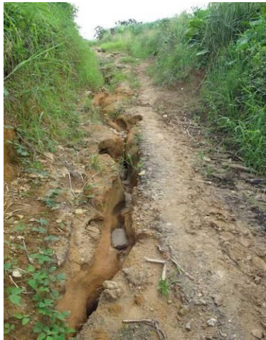
Figura 5: Erosão em estrada vicinal localizada em área de engenho no município de Primavera, PE. A estrada foi recuperada antes da estação chuvosa, meses antes, para a colheita da cana-de-açúcar, segundo informado por moradores locais (foto: do próprio autor).
