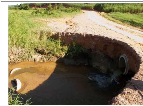
Figura 9: Desmoronamento no entorno de uma passagem em estrada vicinal no município de Barreiros, PE (foto: do próprio autor).
