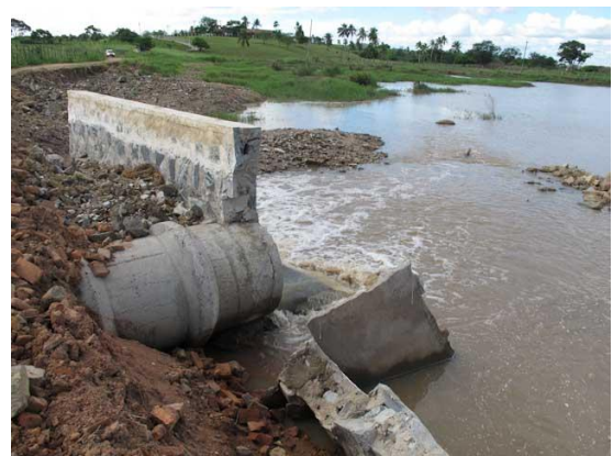
Figura 10: Passagem molhada destruída no município de Pombos, PE (foto: do próprio autor).
