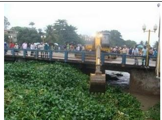
Figura 12: Máguina contratada pela Prefeitura de Gravatá/PE remove as plantas aquáticas que obstruíram a passagem das águas do rio Ipojuca, ameaçando a estrutura da ponte e dificultando a passagem das águas. (Fonte: matutooreporterdepovomanchete.blogspot.com).
